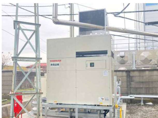
停電対応型コージェネレーションシステム 35kW
